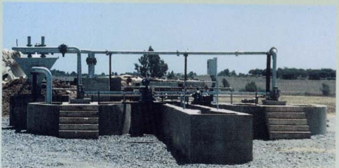
Ouvrages de prétraitement
