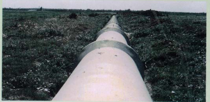
Conduite d'amenée des eaux usées brutes
